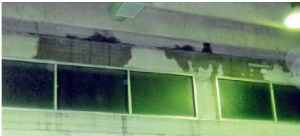
PALESTRA «BUSONI-VANGHETTI» Le infiltrazioni d'acqua che impregnano una delle travi del soffitto e allagano il pavimento
